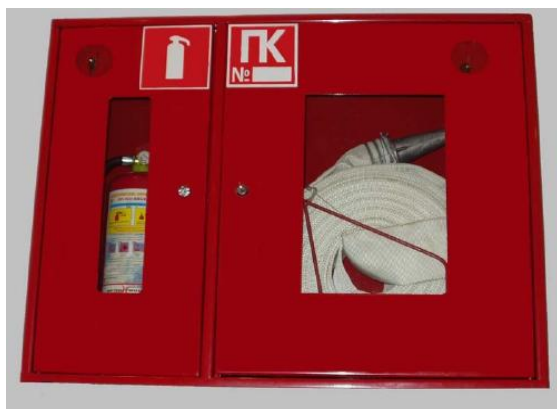
Рис. 32. Внутренний пожарный кран
